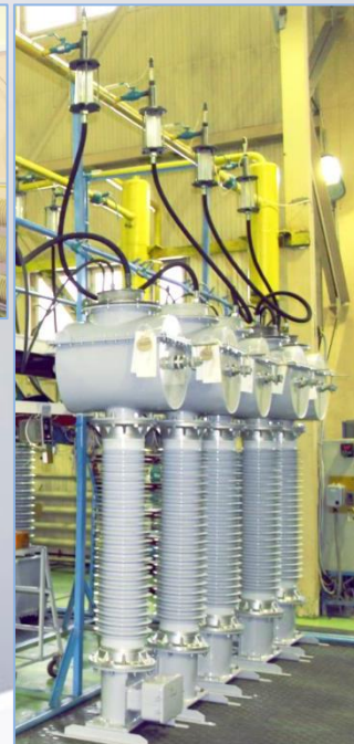
Линия заливки и вакуумировки масла
